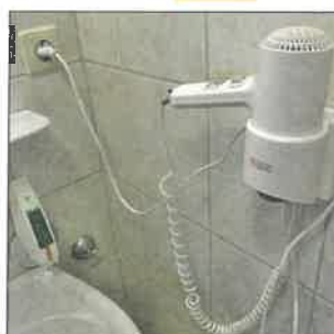
Bild 2: Steckdose im Badezimmer
