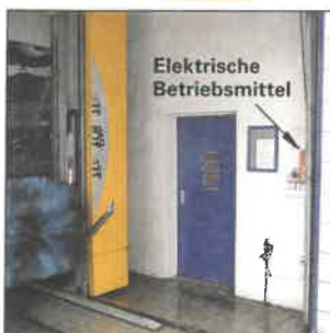
Bild 1: Elektrische Betriebsmittel an der Wand einer Auto-Waschanlage
