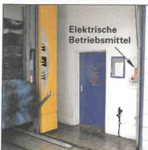
Bild 1: Elektrische Betriebsmittel an der Wand einer Auto-Waschanlage
