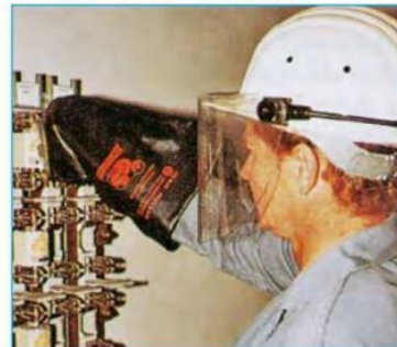
Bild 2: Herausnehmen eines NH-Sicherungseinsatzes
