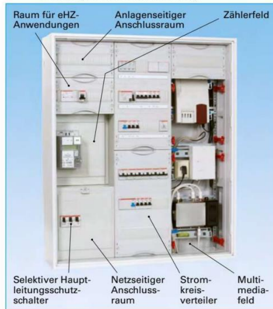
Bild 2: Zählerrahmen mit eingebautem Stromkreisverteiler
